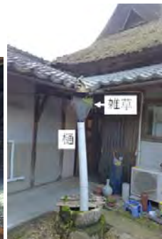
写真5 樋に詰まった雑草 (F邸)
