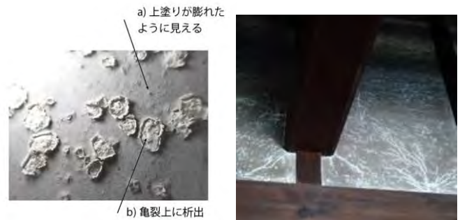
図1 並大津壁の劣化状況（左：広範囲に析出がみられた箇所の拡大、右：線状に劣化している箇所）
